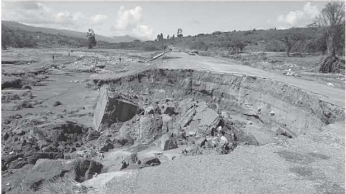
Zerstörte Strasse bei Peacock
